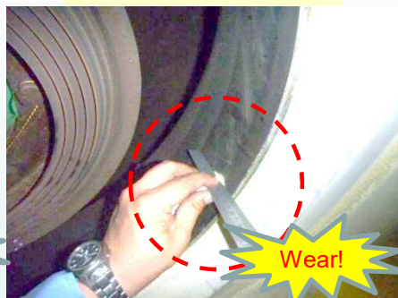
ガス出口案内筒 (局所摩耗の発生)
